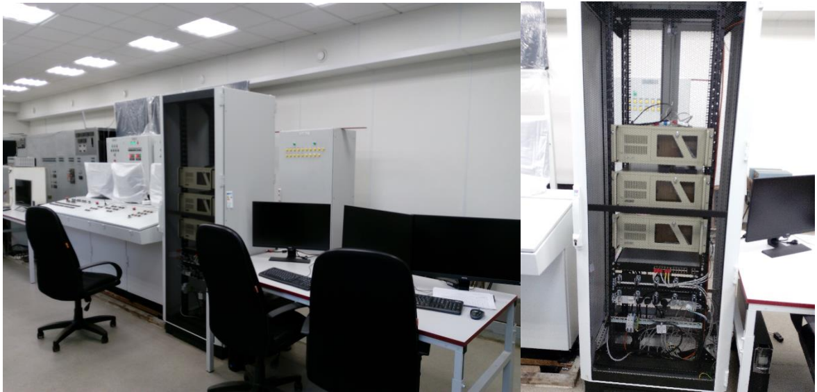
Рабочее место оператора и серверная стойка
